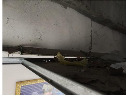
Struktur logam yang dipasang untuk menyokong plaster siling dan dawai besi didapati putus
