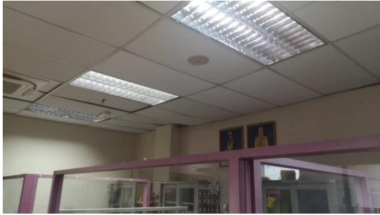
Kesan runtuh plaster siling susulan bunyi kuat pada 15 Mei 2025
