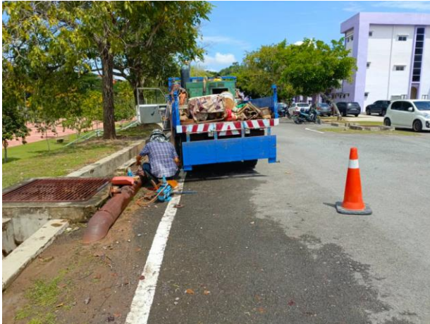
Kebocoran paip air pada 21 April 2025
