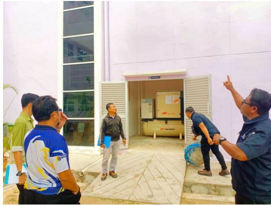
Kerja pemeriksaan semula pentauliahan perlesenan mesin pemampat udara dijalankan pada 6 February 2025.
