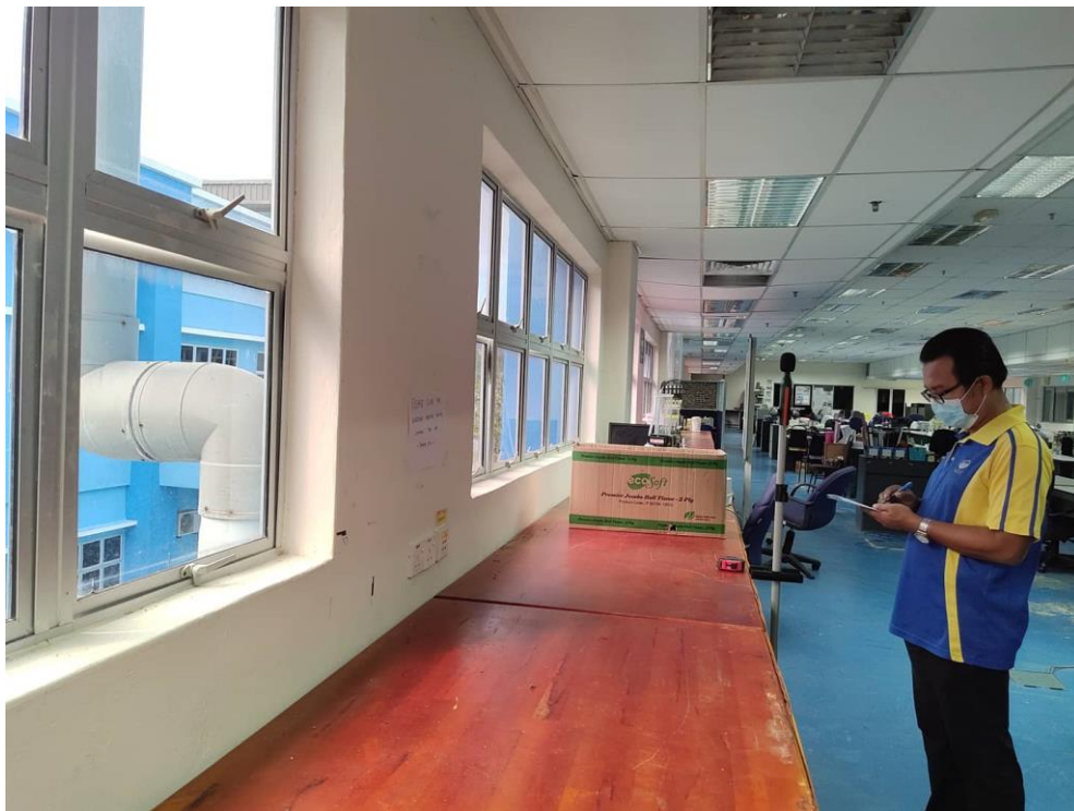
Exhaust Fan (Fume Hood)
